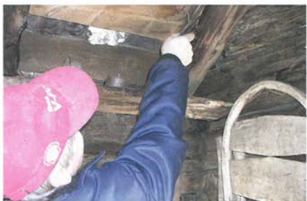
Gamle roteskader hadde fått utvikla seg under fuktige forhold. Her frå synfaring i Gamlastova.
