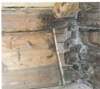
På lemnen, i hjørnet ved pipa, ser me korleis novrekka er skada, og korleis veggen vert pressa ut.
