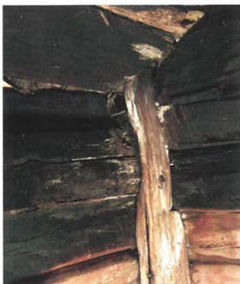
Der er mykje skader i Gamlastova, mellom anna bak bordet i sør-vestre hjørne.
