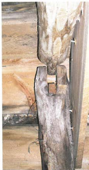
Sperra er glidd frå einannen i samanføringa. Ved vedlikehaldet i 1981, vart det sett på ein klamp for å halda sperra saman.
