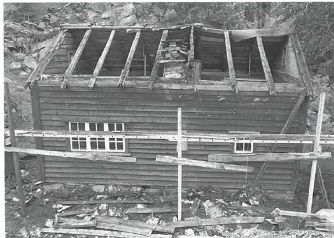
Biletet frå 1981 er tatt før dei fjerna taktekinga på nordsida. Her ser me at skadane rundt pipa er der alt då. Også sperra er laska på, men klampen i samanføringa er ikkje kome på.
