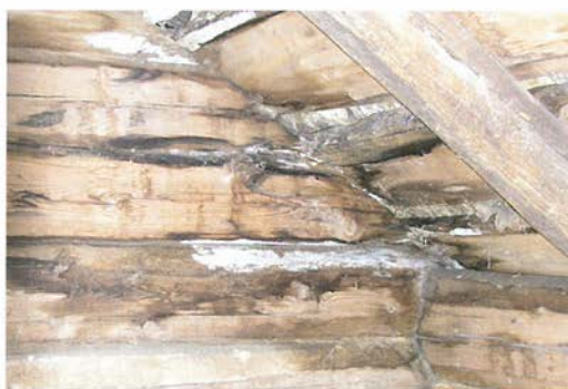
Soppskadar i sør-austre hjørne.
