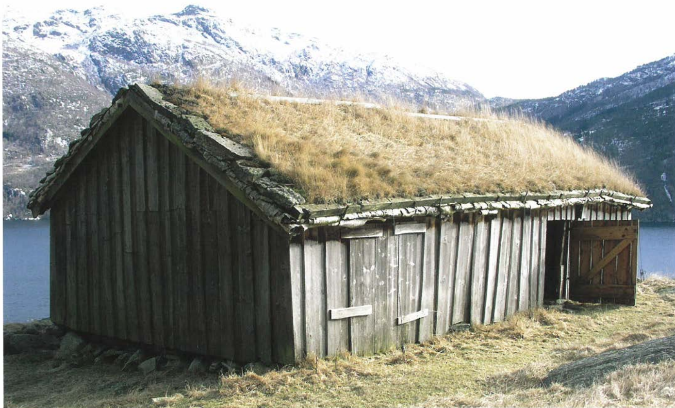
Løa tatt i 2006. Dei to oversiktsbileta frå Riksantikvaren, som er vist tidlegare i artikkelen, viser korleis løa ein gong så ut, med fjøs og vedaskut mot nord, og med do på nedsida. I dag er det berre murane att av fjøset.
