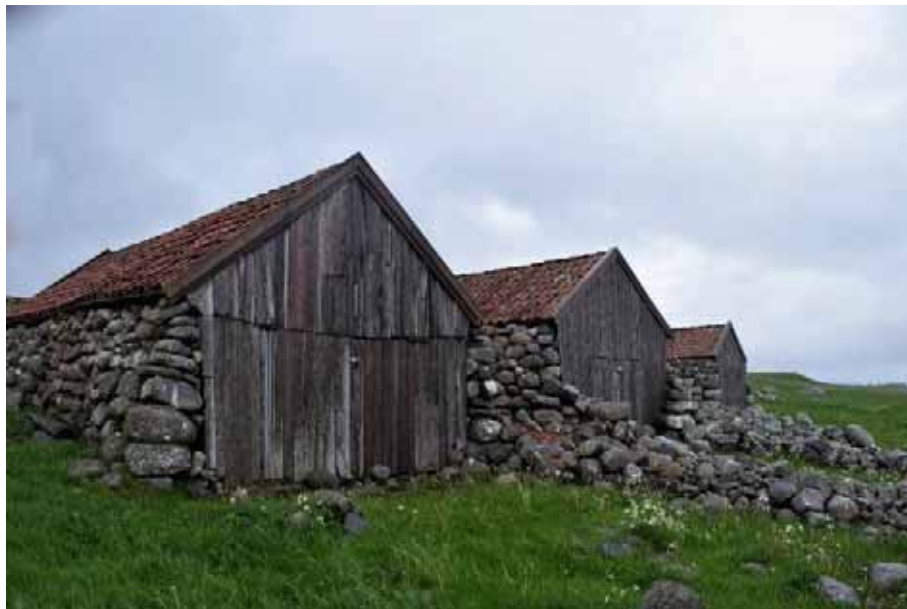
Figur 94 – Nausta på Varhaug er vurderte til tilstandsgrad 2.
