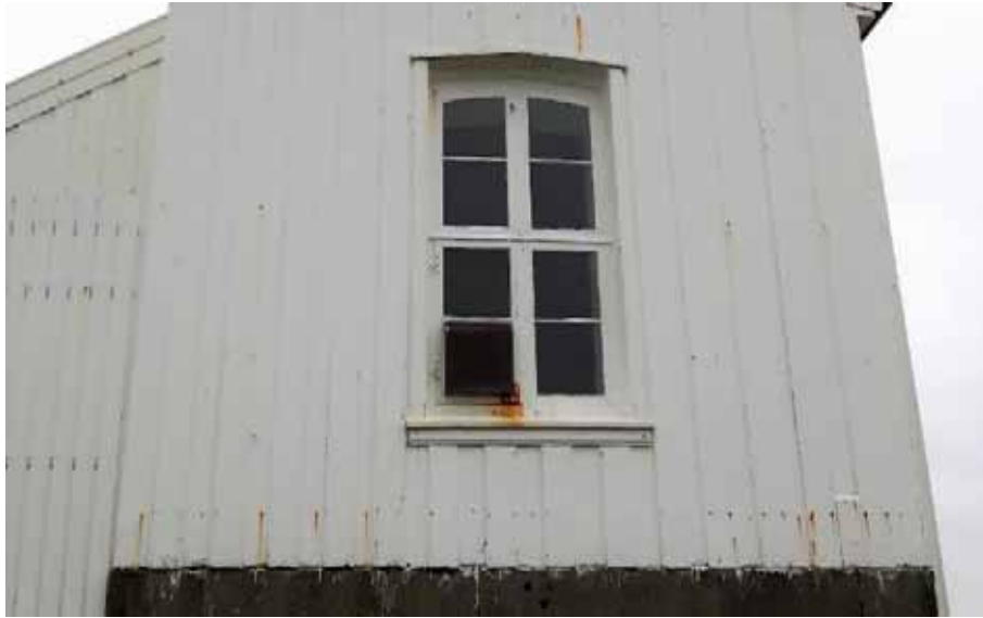
Figur 138 – Fyrbygningar er truleg dei bygningane som blir utsette for størst påkjenningar av vêr og vind. Her er fyrbygningen på Tonjer. Sjølv kort tid etter at bygningen er måla, kjem rustflekkene fram. Den salte og fuktige lufta gjer vedlikehaldet til ei stor utfordring.
