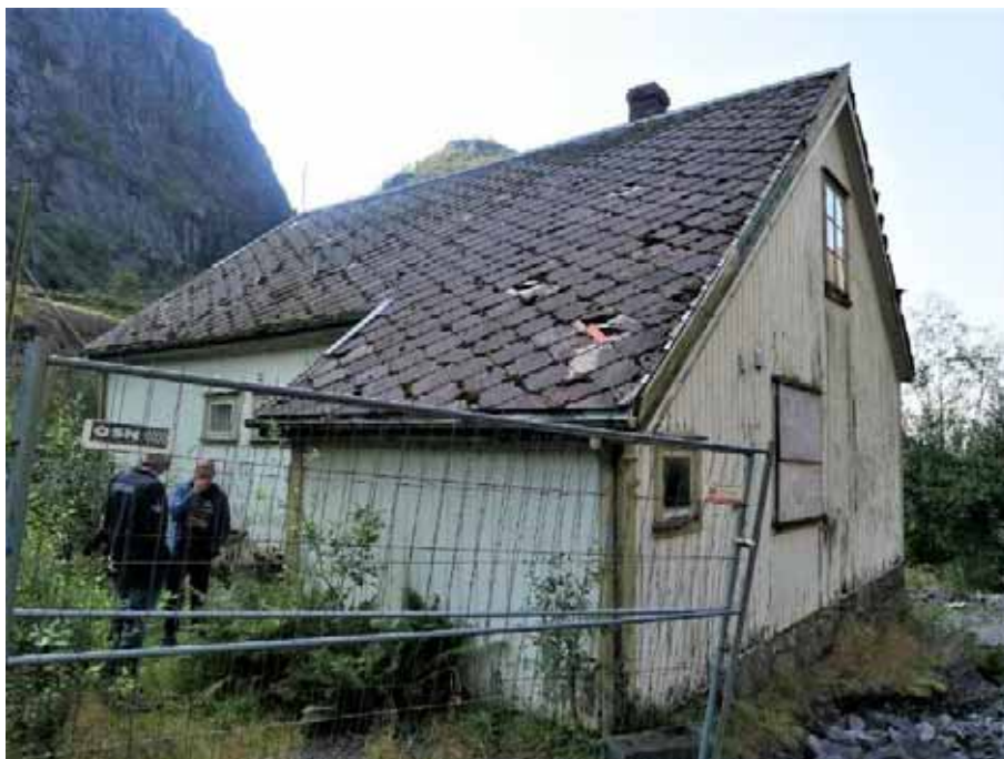
Figur 112 – Arbeidarbustaden i Jøssingfjord er ein av bygningane som museet har fått hand om i nyare tid. Her er det behov for istandsetjing i løpet av dei næraste åra.
