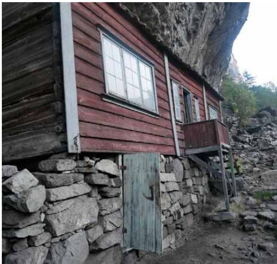
Figur 98 – Det raude Helleren-huset er vurdert til tilstandsgrad 2.
