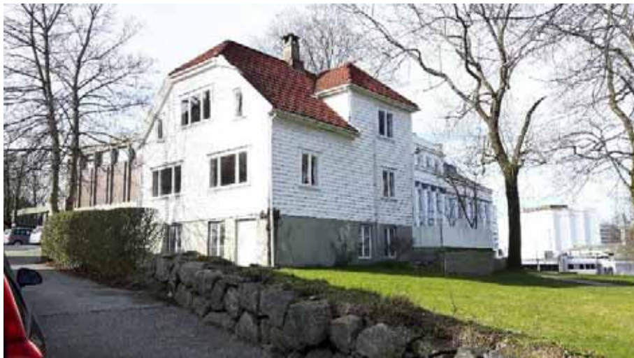
Figur 108 – Dette huset i Peder Klows gate er eit av dei første husa museet overtok. Det er behov for istandsetjing både utvendig og innvendig
