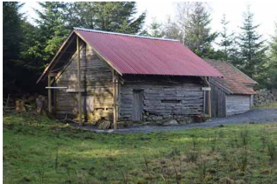
Figur 106 – Forfallet på våningshuset på Laupland (Bokn bygdemuseum) er kome langt, og det er sett inn sikringstiltak med eit provisorisk takoverbygg medan ein ventar på meir ressursar.
