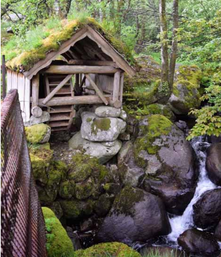
Figur 95 – Hjulhuset på Nordland er vurdert til tilstandsgrad 3.
