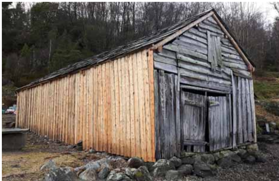
Figur 102 – Naustet i Vigavågen (Hjelmeland kommune) høyrer til Ryfylkemuseet og er eit av bygga som blei sett i stand med sysselsetjingsmidlar i 2016. Delar av stavkonstruksjonen måtte bytast. Det same gjaldt sperretaket. I tillegg blei det lagt ny kledning, og taket blei tekt med dei same villhellene som tidlegare. Bygningen blei slik løfta frå TG3 til TG1.
