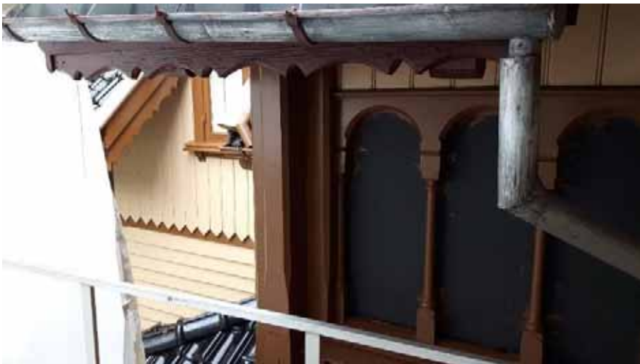
Figur 136 – Prøvofelt på fasaden på Breidablikk. Til venstre ser me den nye fargen (sandfarge) med brunmåla detaljar.
