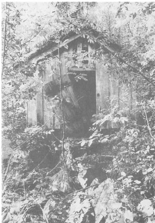
Fullt så bra står det ikkje til med dei to kvernhusa i Fisketjøns- hagane på Suldalsosen. Appetitten på kvernhus har vore større enn evna til å vedlikehalde dei. Såpass utilgjegeleg som enkelte av dei ligg kan det og stillast spørsmål ved den verdien dei måtte ha for museet.
