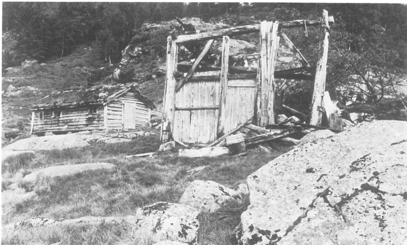
«Eit forhold som dessutan har bekymra styret svært er vedlikehaldet av bygningsmassen til museet». Bildet viser Midtstølen under Kolbeinstveit, der låa har ramla ned.
